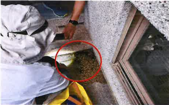
樓梯地面積水
