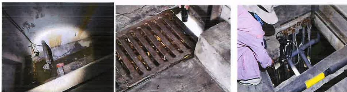
地下室集水井
